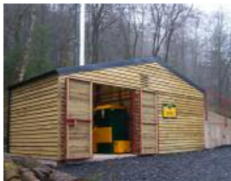
Fig 2: Dol Llys 60kW KWB boiler
