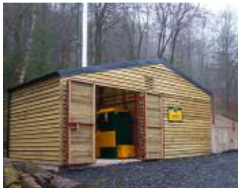
Fig 2: Dol Llys 60kW KWB boiler
